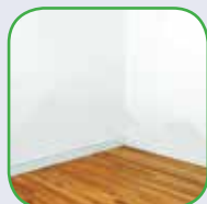
Paredes com Umidade Ascendente
