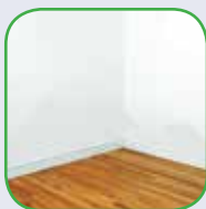
Paredes com Umidade Ascendente
